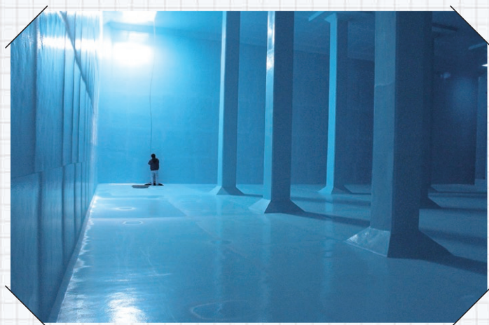
内面補修完了後、運用前の配水池内部の様子 二村山配水池(豊明市)
